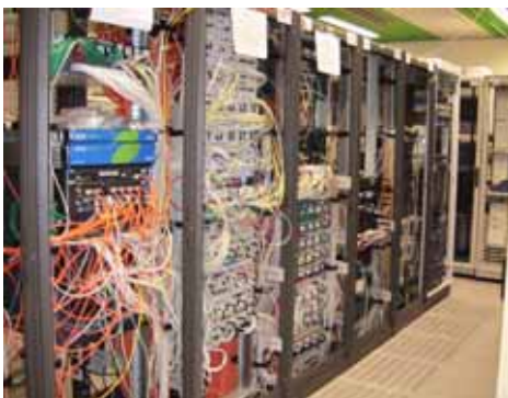
Blick in den zentralen Serverraum des IMT
