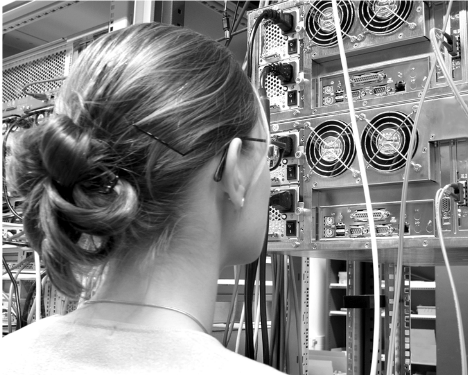
Abbildung 13: Blick in den Serverraum des IMT
